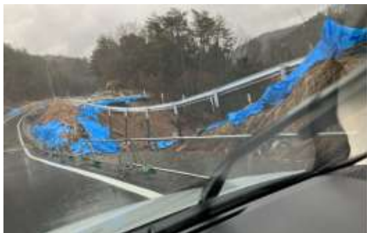
のと里山街道の道路被害
